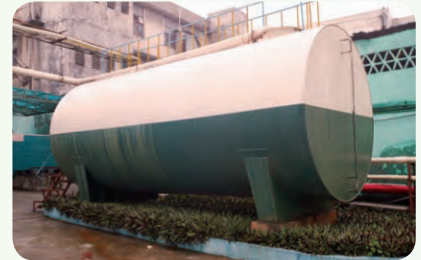
廢水處理系統
